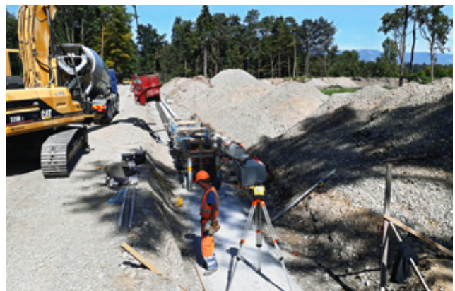
Bauarbeiten für die Überflussskante, die dafür sorgt, dass das Wasser von der Strasse (links) kontrolliert in die Auslaufmulde (rechts) abfließt.
